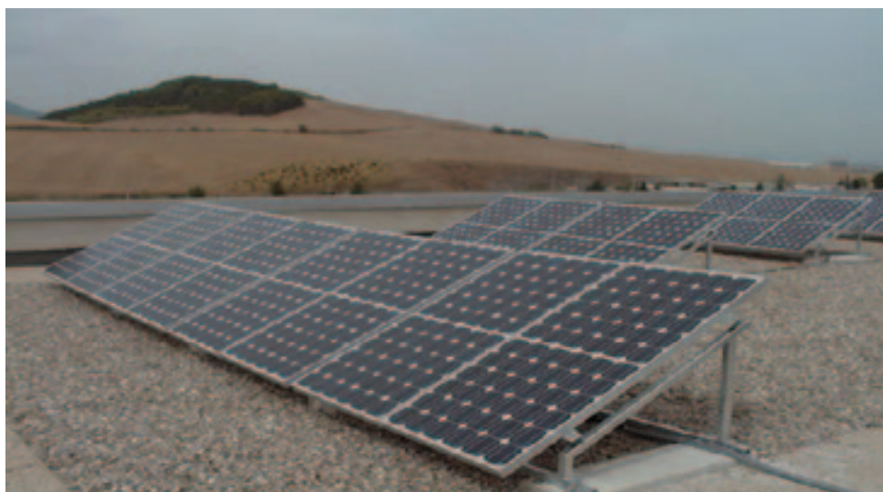
Foto 4. Sistema fotovoltaico sobre tejado plano.
