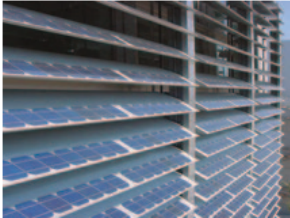
Foto 8. Instalación fotovoltaica integrada en lamas.
