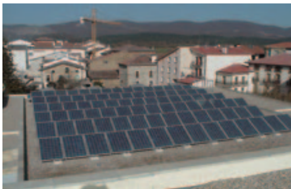
Foto 2. Instalación conectada a red.
