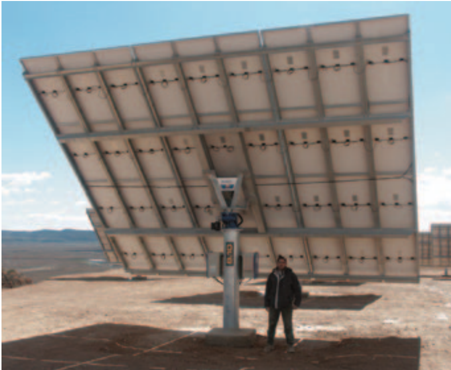
Foto 5. Instalación fotovoltaica sobre seguidor solar.
